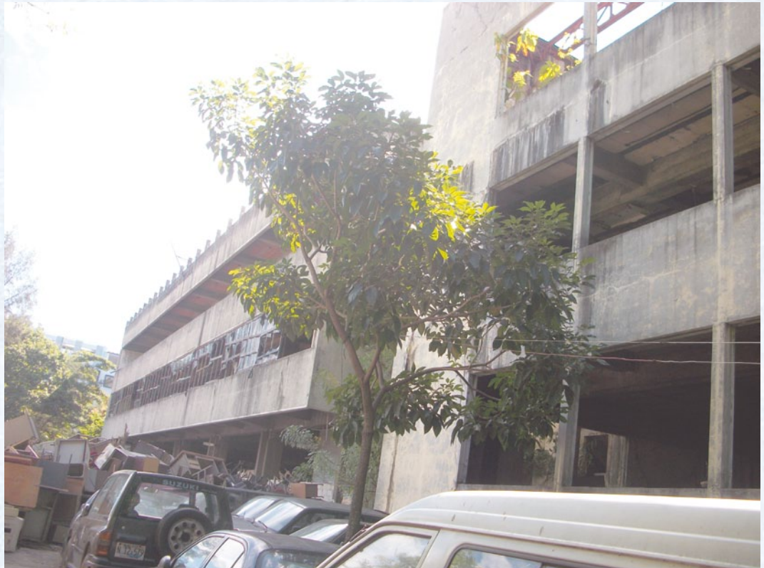
Así luce actualmente el edificio destruido por el terremoto de 1986.
